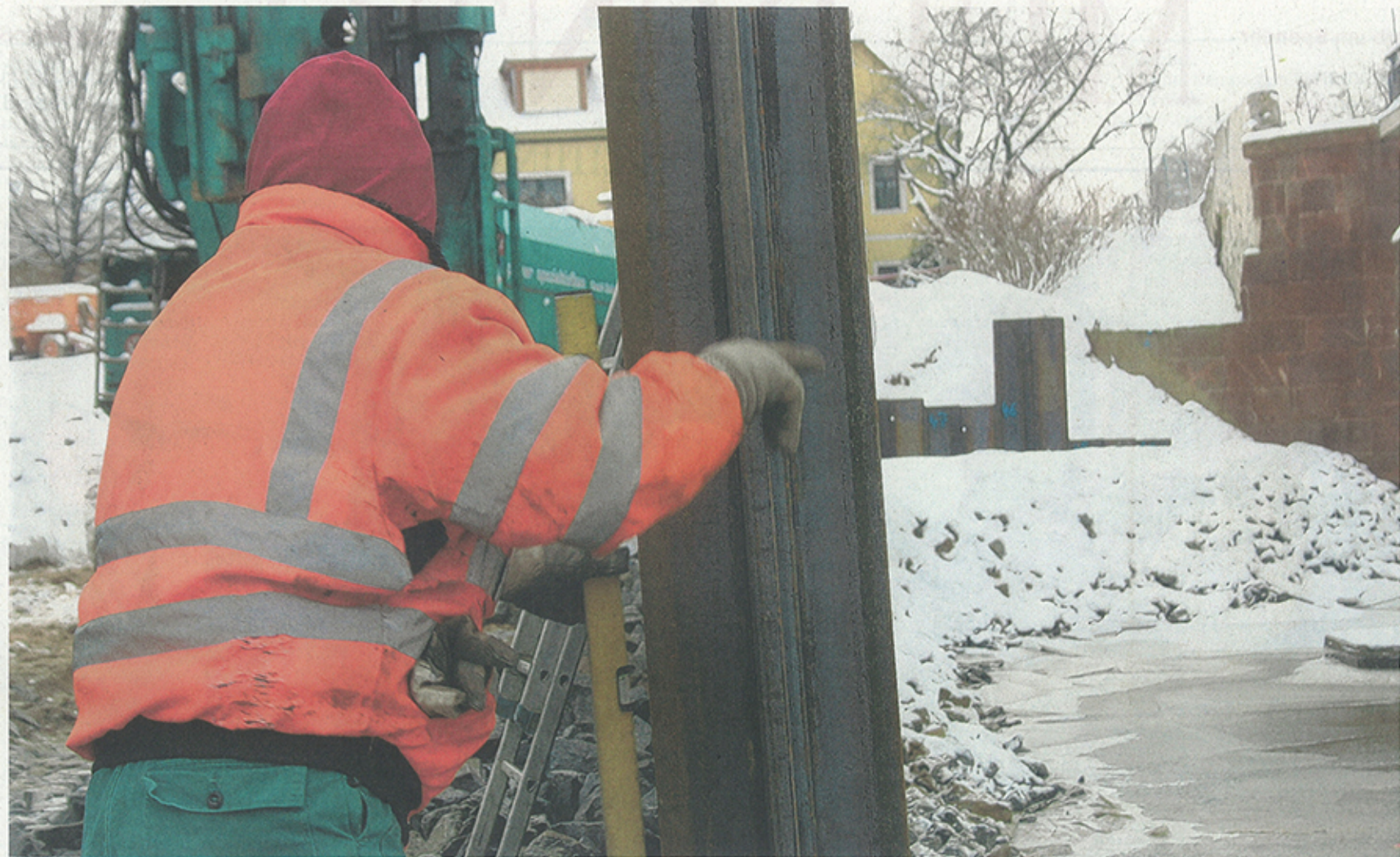
Präzisionsarbeit bei Eis und Schnee: Dick eingemummelt in warme Klamotten weist Klaus Pezl den Fahrer der Ramme ein, die die schwere Stahlbohle ins Bett der Mulde treibt. An der Brückenbaustelle geht die Arbeit trotz Frost weiter. Foto: André Neumann
